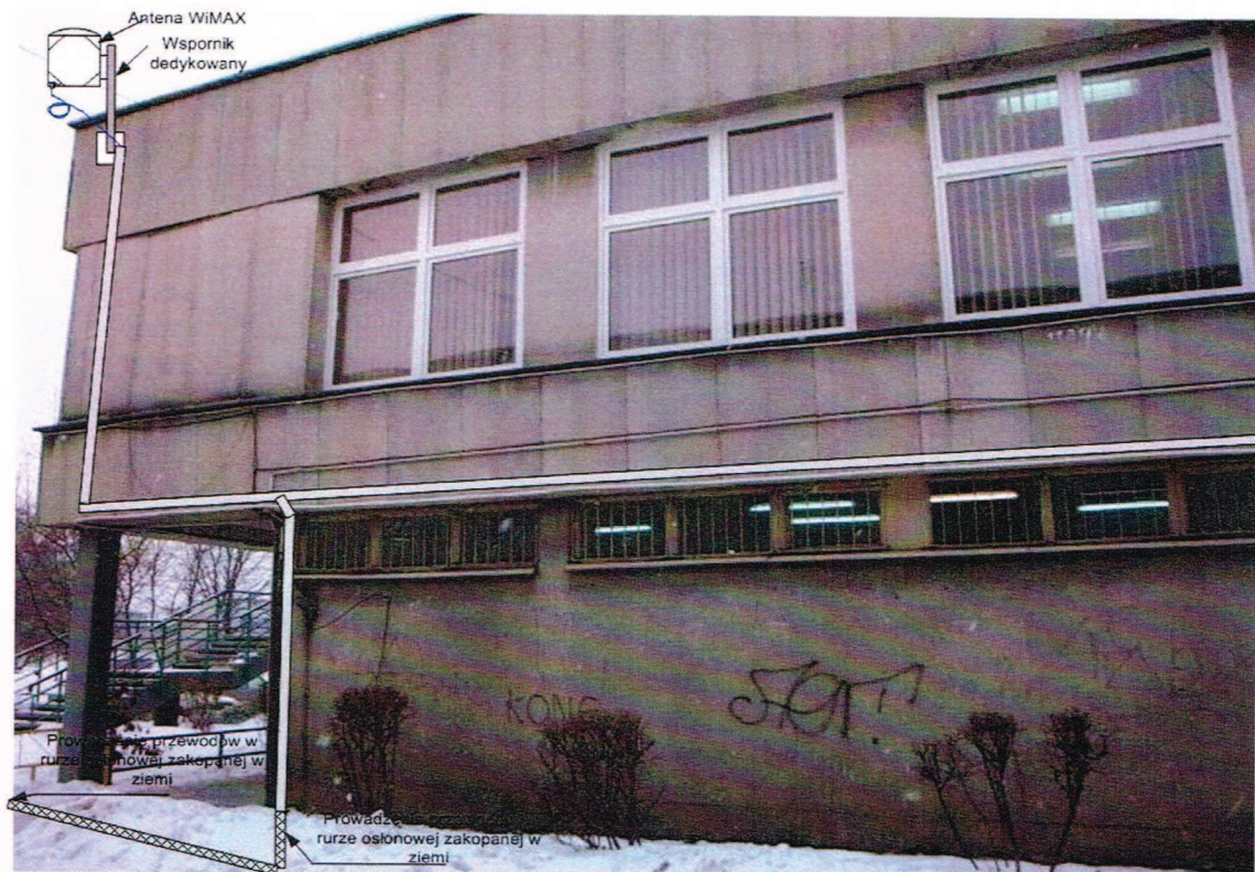
Rys. 37 Miejsce montażu urządzenia abonenckiego WiMAX oraz trasa kablowa do Infokiosku
