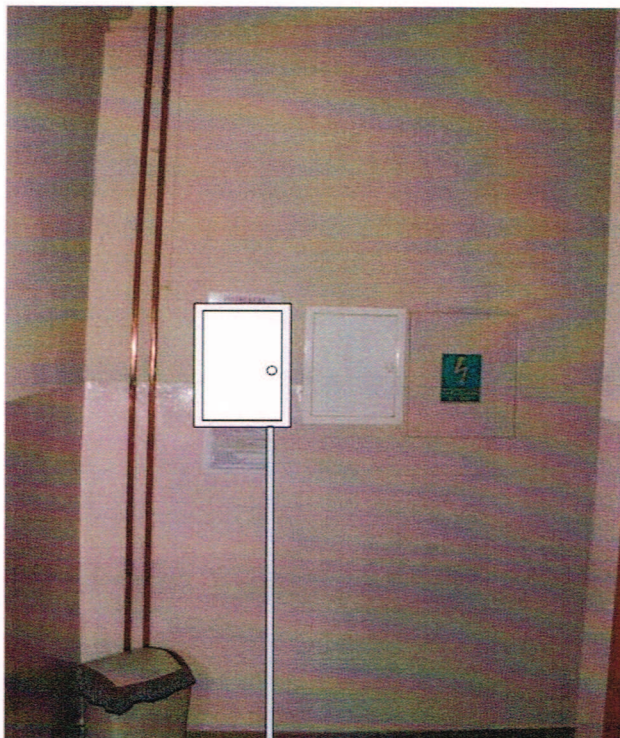
Rys. 51 Miejsce podlicznika energii elektrycznej
