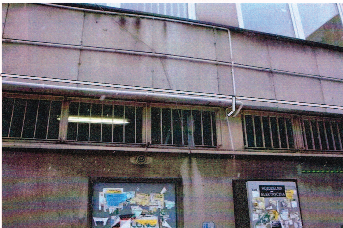
Rys. 36 Trasa kablowa ze skrzynki teletechnicznej do Infokiosku, urządzenia abonenckiego WiMAX i routera WiFi
