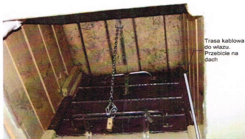
Rys. 21 Trasa kablowa z szafki teletechnicznej do urządzeń nadawczo-odbiorczych systemu WiMAX i radiolinii
