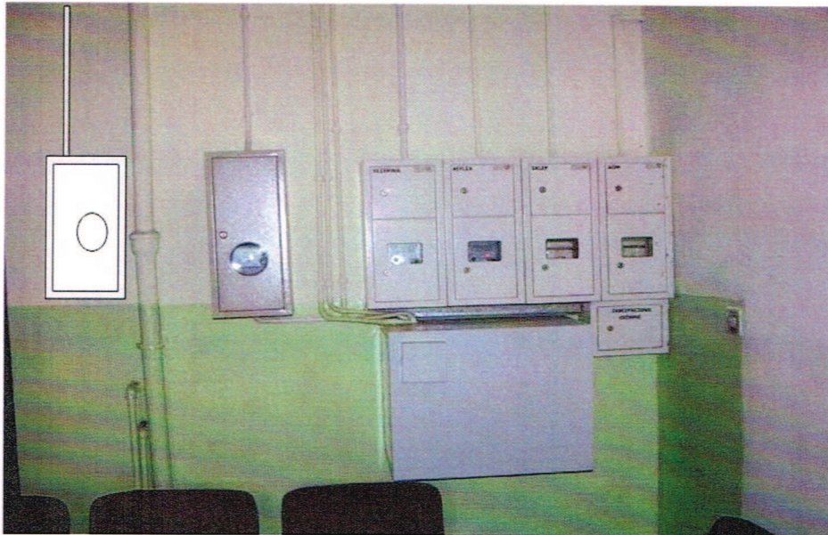
Rys. 67 Miejsce montażu podlicznika energii elektrycznej
