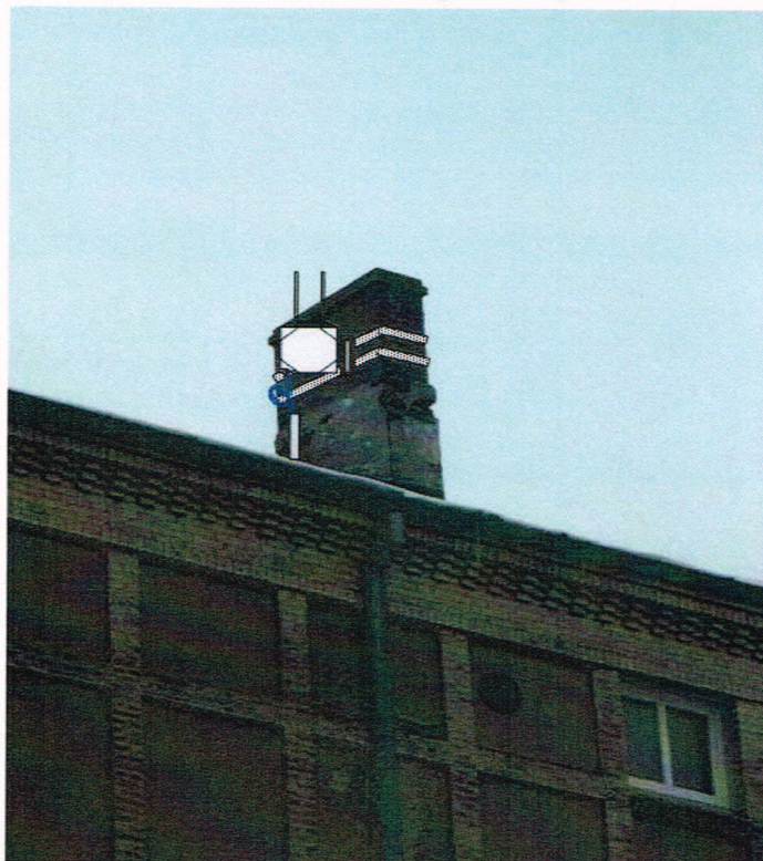
Rys. 98 Miejsce montażu urządzenia abonenckiego WiMAX
