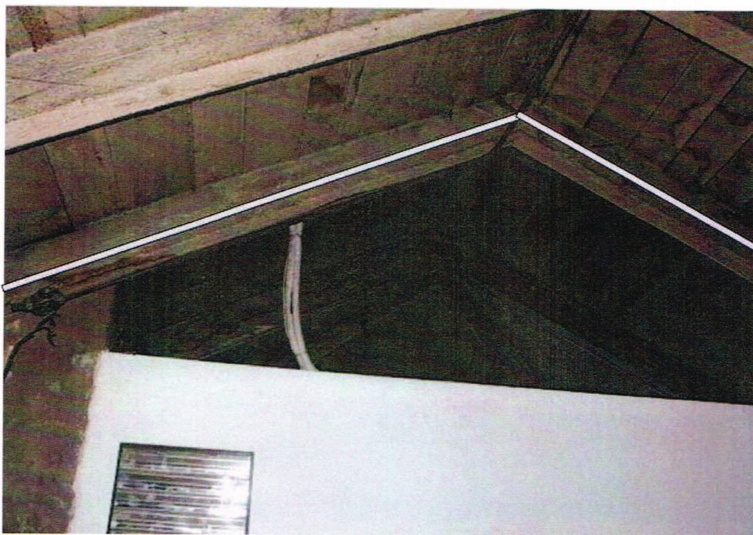
Rys. 93 Trasa kablowa z szafki teletechnicznej do urządzenia abonenckiego WiMAX.
