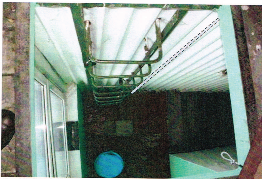
Rys. 117 Trasa kablowa z szafki teletechnicznej do urządzenia abonenckiego WiMAX
