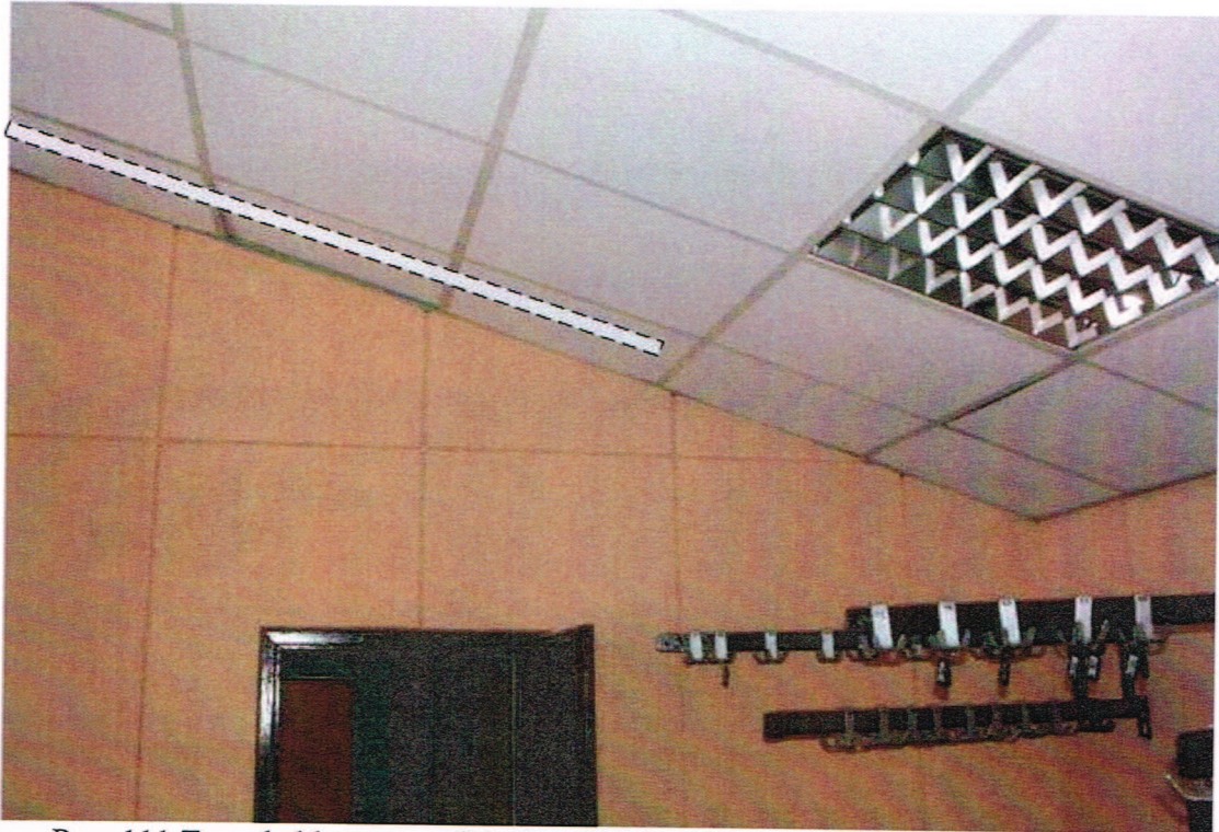
Rys. 111 Trasa kablowa z szafki teletechnicznej do Infokiosku, routera WiFi i urządzenia abonenckiego WiMAX
